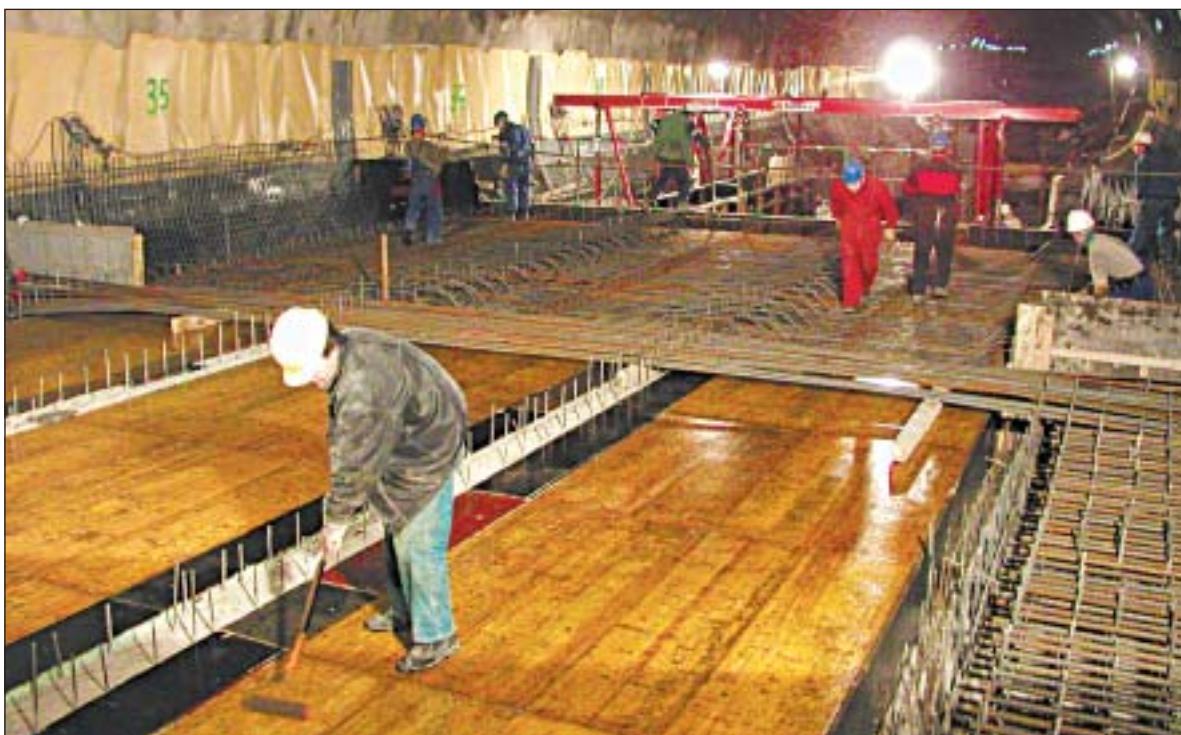
Po stranách je vidět čerstvě zavěšená izolace, která pak bude zakryta další betonovou obezdívkou. Právě se připravuje silnice; ta celým tunelem pod Mrázovkou vede vlastně na jakémsi mostu.
