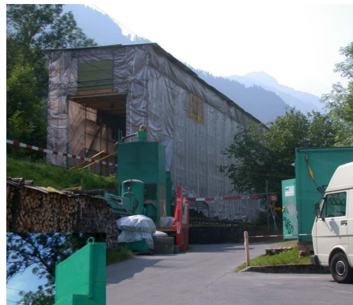
↓ Při pískování původního nátěru se uvolňuje olovo, proto musí být veškerý odstraněný materiál bezpečně zachycen.
